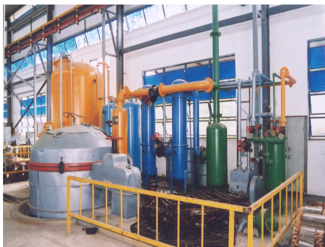
Hệ thống tẩm sấy chân không, tẩm sơn cách điện cho bộ dây động cơ / The vacuum impregnated varnish system for Stator of Motor
